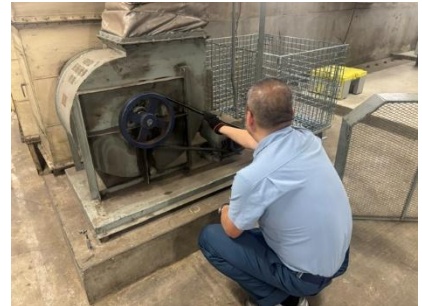
ファンベルトの張り、劣化状況の確認
