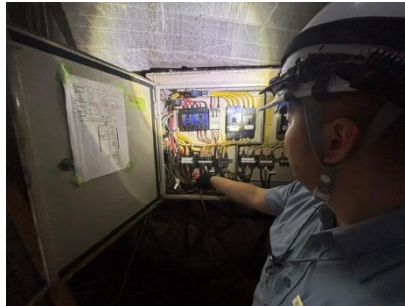
配電盤の結線状況の確認
