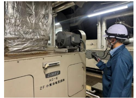
モーター軸受け部の異音確認
