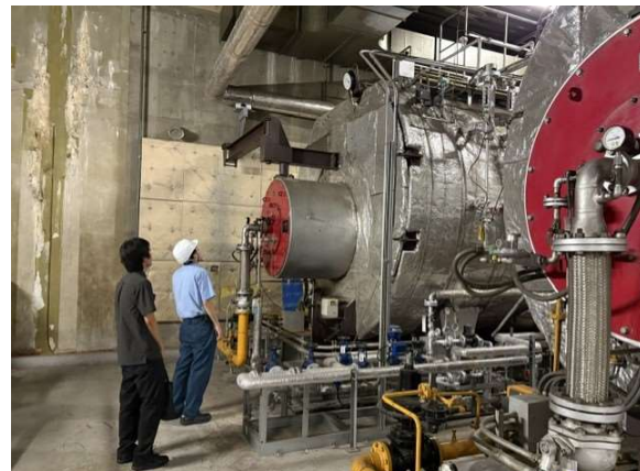
大きなボイラー施設を間近で見学
